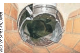
Rattenfalle mit ausgefahrenen Bolzen (oben) und nach Einbau im Abwasserkanal.
