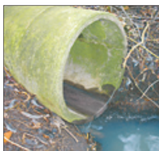
In den Bürgermeisterkanälen sammelte sich Ab- und Regenwasser.
