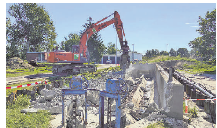
Der alte Sandfang wird abgerissen. Vorn im Bild: die beiden Schieber. Gut zu erkennen sind die beiden Gerinne, die auch im neuen Sandfang in dieser Form gebaut werden.
