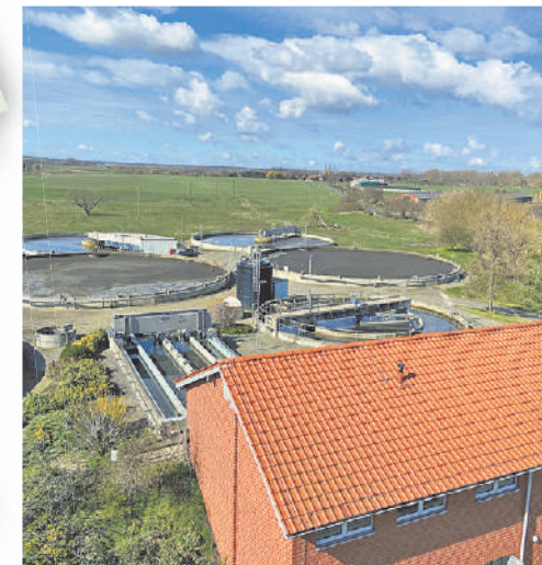
Die zentrale Kläranlage in Hillersleben ist die größte im Verbandsgebiet. Hier kommen täglich rund 5.000 m 3 Abwasser an. Foto: AVH
