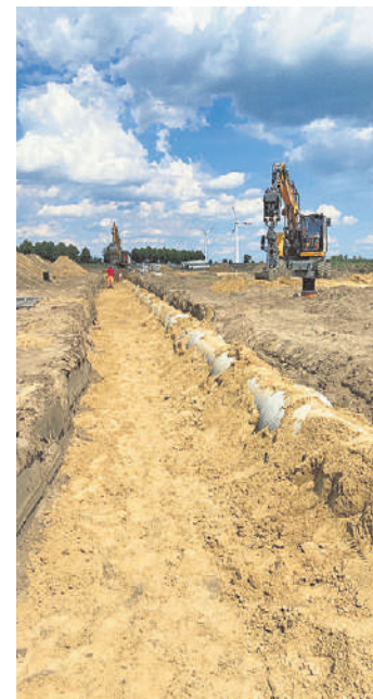
Die Tiefbauarbeiten laufen reibungslos, auch die Corona-Krise hat kaum Verzögerungen verursacht. Rechts: Im März starteten die Arbeiten offiziell mit dem Spatenstich. Fotos: AVH/Fahrenkamp, SPREE-PR/Wöhler
