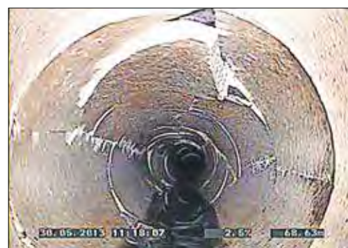
Scherbenbildung, Rohrschaden auf voller Länge
