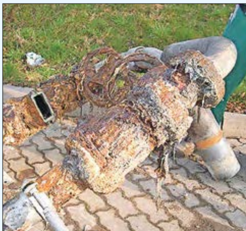
Hat auch schon bessere Tage gesehen: die alte Steigleitung.
