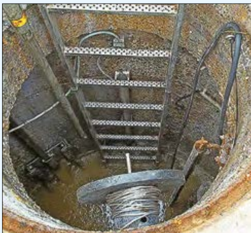
Blick in die Pumpstation vor der Sanierung: Der Beton ist ziemlich „angefressen“.
